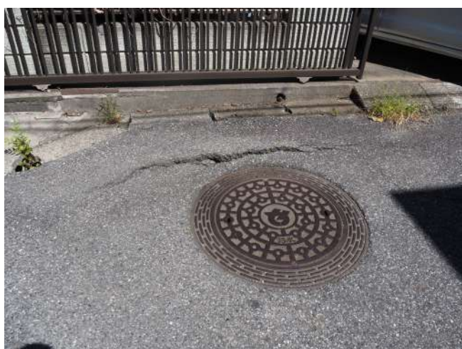
9 道路のひび割れ
