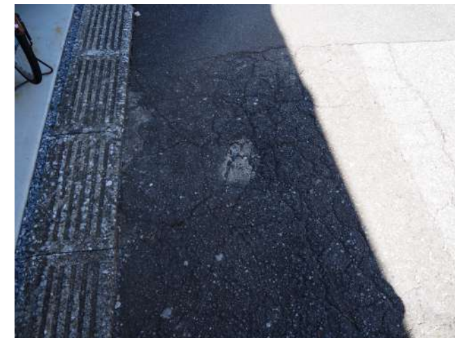
4 道路の陥没(小)
