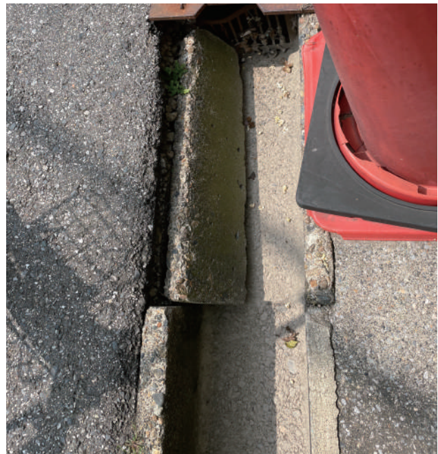
側溝の一部が破損
