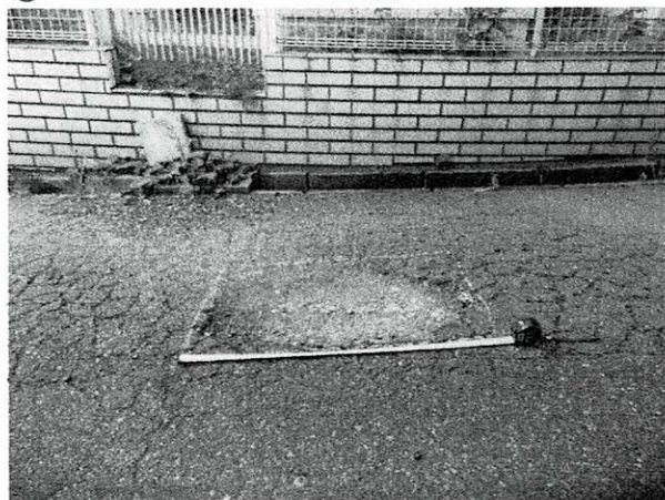
⑤ ポットホール2 近景
